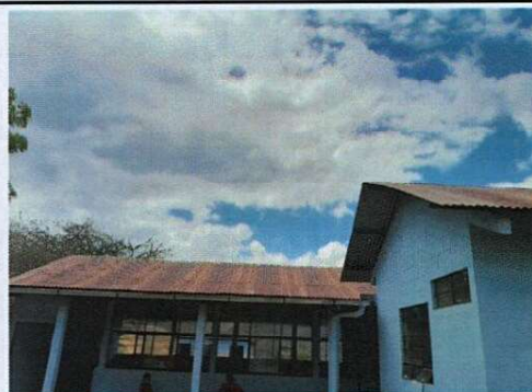
Foto 2: Sustrucción de lámina en área de aulas
